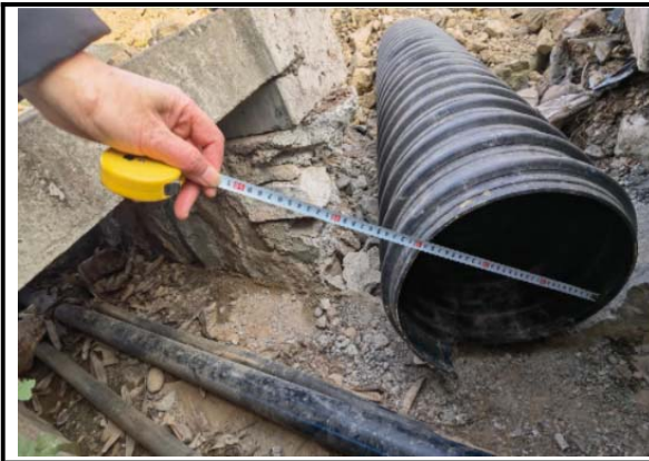
波纹雨水管排出口
