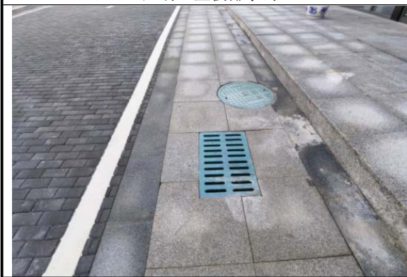
道路旁的雨水检查井
