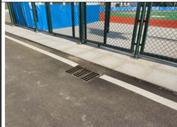
道路旁的雨水口
