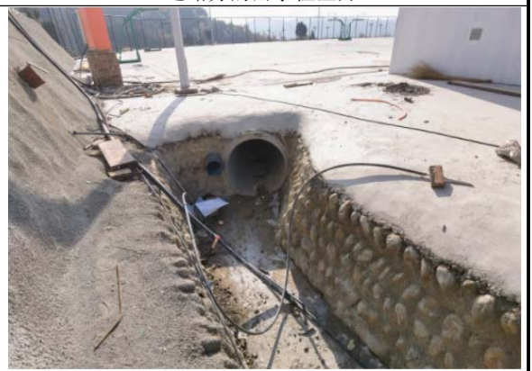
体育中西东侧砼雨水排水管
