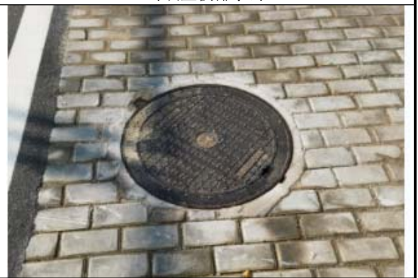
道路旁的雨水检查井
