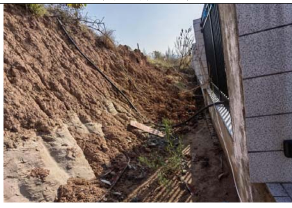
学生食堂北侧个别开挖边坡垮塌需清除
