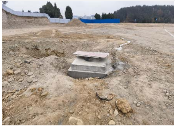
雨水管检查井
