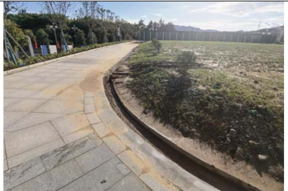
需加强排水沟清淤管理工作
