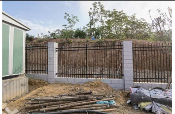
需采取防护措施的开挖边坡
