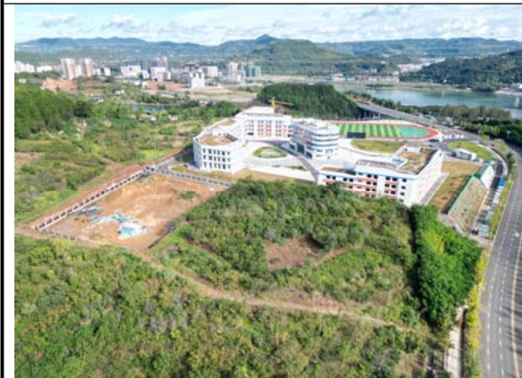
需对幼儿园工地采取防护措施
