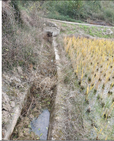
嘉陵水库干渠天然石渠现状（边墙风化严重，底板淤积、渗漏）
