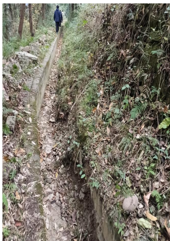
三岔沟水库干渠天然石渠现状（边墙风化）
