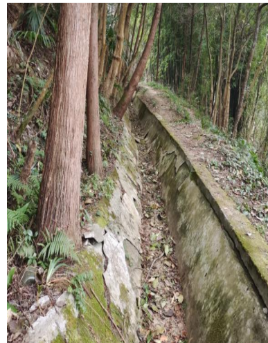
三岔沟水库干渠现状（渗漏严重，底板淤）
