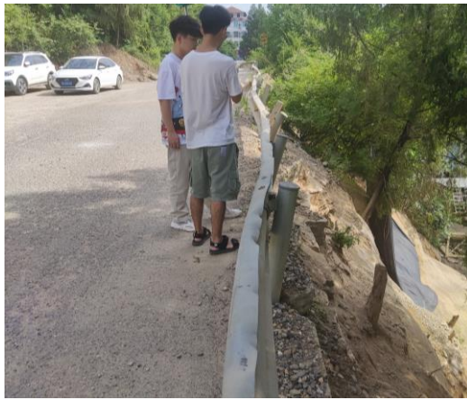
挡墙裂缝、外倾
